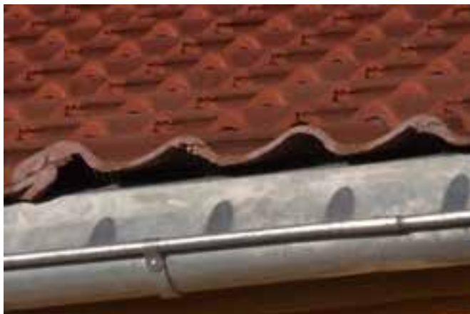
Billede: Dryp fra betontagsten
